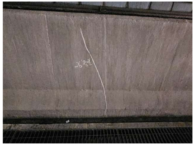
안전 및 기타시설(하부 방호벽(좌)) S1 균열(0.3mm미만)
