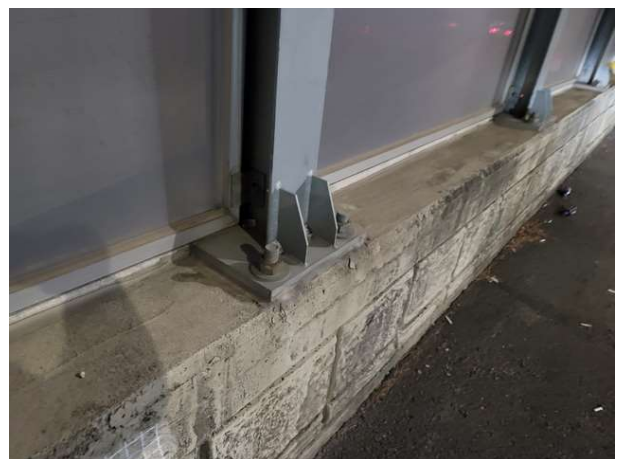
S2 기초연결부(좌) 상태현황
