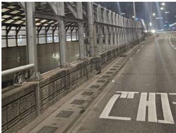
S1 기초콘크리트(우) 상태현황
