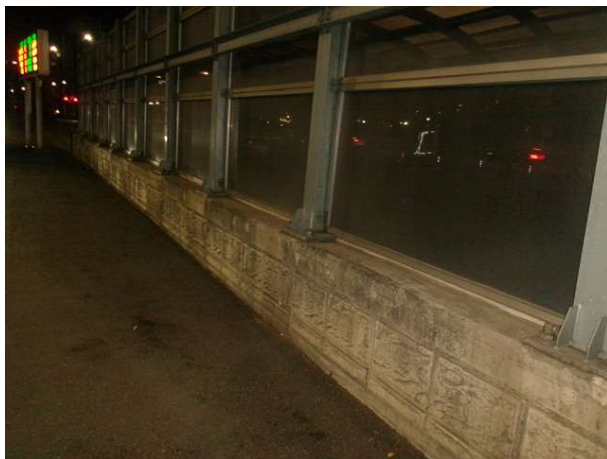
S1 기초연결부(좌) 상태현황
