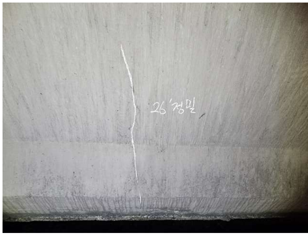
안전 및 기타시설(하부 방호벽(좌)) S1 균열(0.3mm미만)
