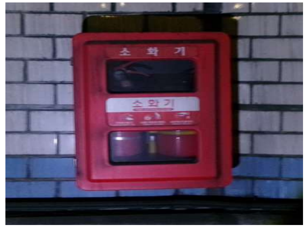
방재시설(소화기) S01 상태현황
